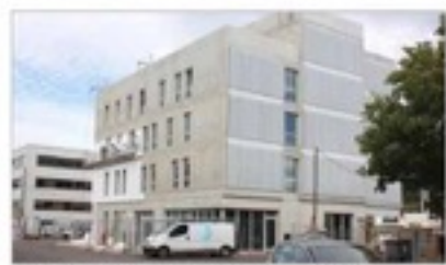
Le deuxième bâtiment en cours de construction dans la ZAC accueillera le siège de la Compagnie des Alpes et les bureaux de la SAS qui commercialise la zone du Grand-Verger. D'ici la fin de l'année doit débuter la réalisation du troisième immeuble pour Effage.
